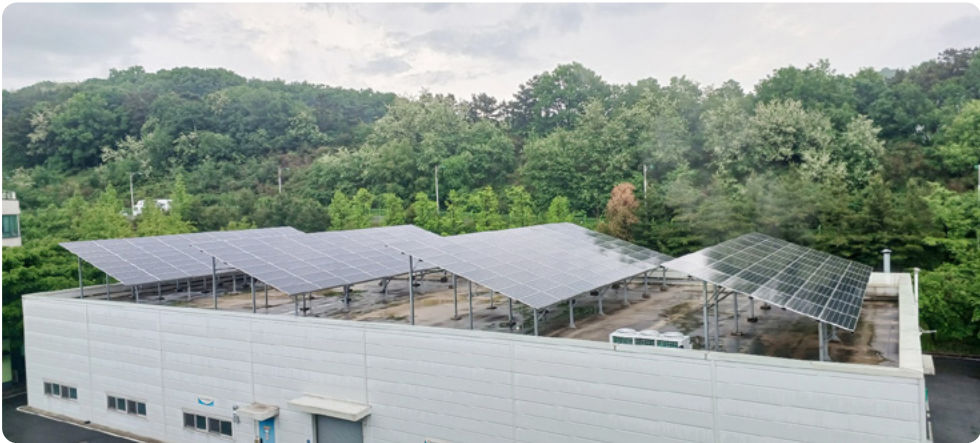
충주공장 태양광발전 설비
